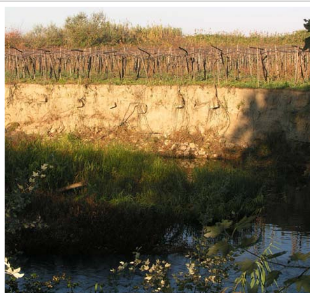
Fig. 13. Vigneto abusivo sull'argine. Foto: M. Marrese
